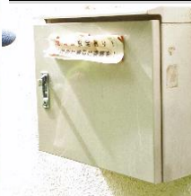
コントロール Box
