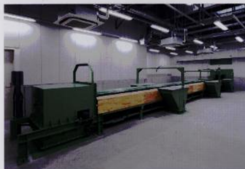
びん手選別コンベヤ 手作業によりびんを色ごとに選別します。
