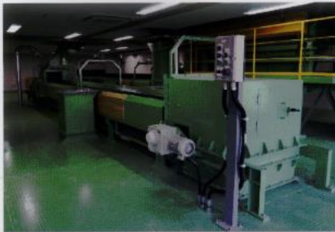
ペットボトル手選別コンベヤ 手作業によりペットボトルに混入した異物を取り除きます。
