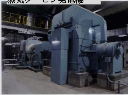
蒸気タービン発電機
