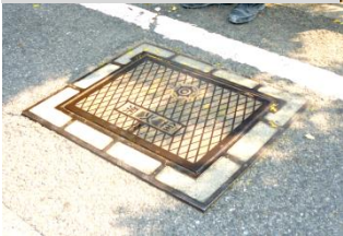
消火栓の蓋が閉じた状態
