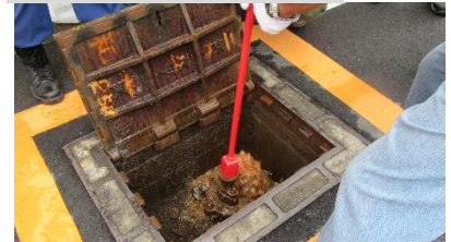
先ず錆びた水を流し出す
