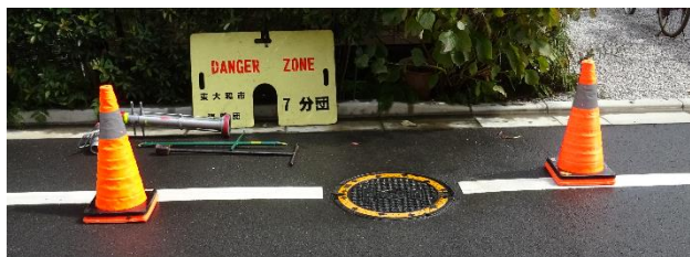
給水に使用した消火栓
