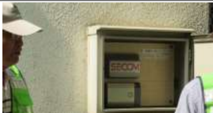
コントロール Box 蓋の操作確認
