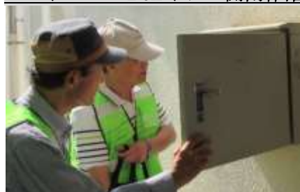
コントロール Box ドアの開閉作確認
