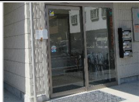
高齢者ほとんがいがい被災状況
