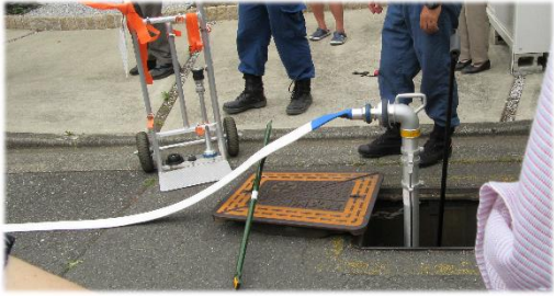
消火栓にスタンドパイプを装着した状態
