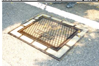
消火栓の蓋が閉じた状態
