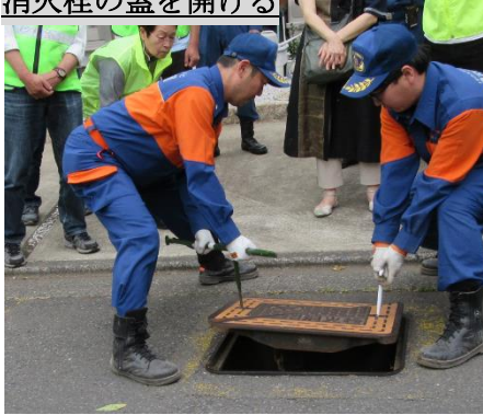
消火栓の蓋を開ける
