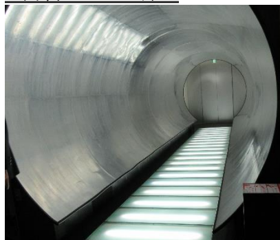
貯蓄タンク内部
