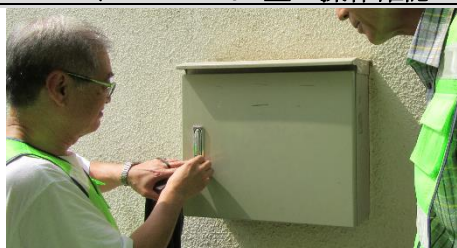
コントロール Box 蓋の操作確認
