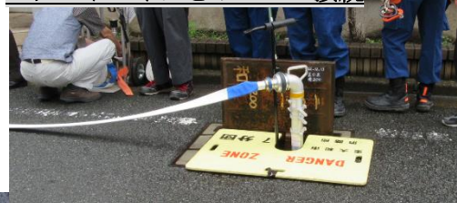
スタンドパイプとホースの接続
