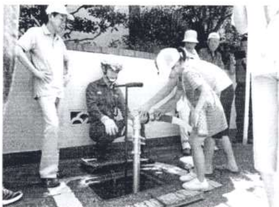
スタンドパイプとホースの接続
