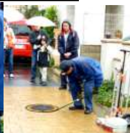
消火栓の蓋開け操作
