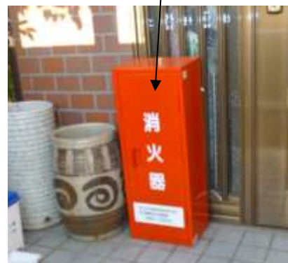
消火に使用した消火器 BOX
