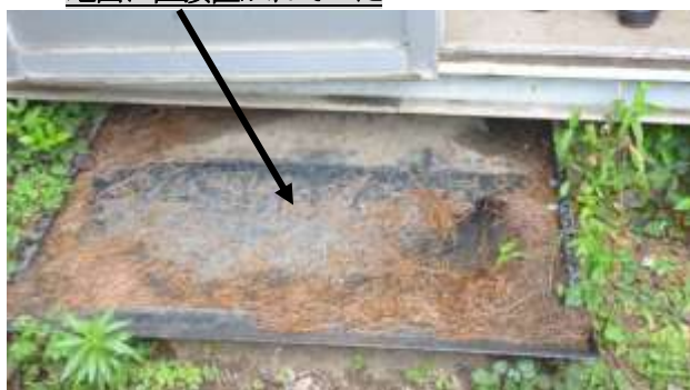
入口のスロープ設置板（鉄板製） 地面に直接置かれていた
