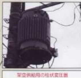
架空供給用の柱状変圧器
