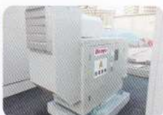
非常用発電機
