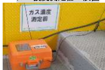
ガス濃度測定器の設置
