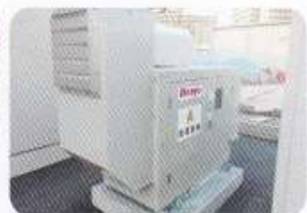
非常用発電機 サービスセンターが震災対応をするために必要な電源を確保する設備です。
