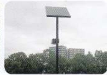
防災用照明灯 (ソーラー照明灯)
