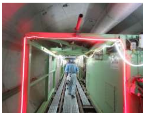
この奥にシールドマシンが設置されている
