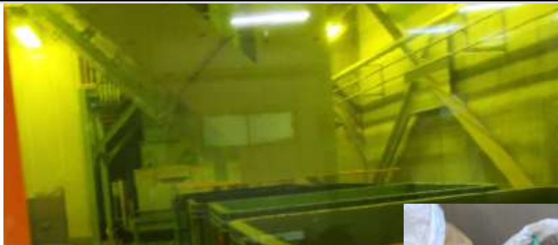
不燃ごみ手選別部屋からの選別品貯留所(2階から一階へ落下させる)
