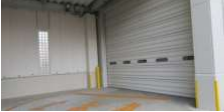
パッカー車搬入口(扉) ; エアーカーテン設置
