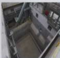
③ 不燃ごみピット
