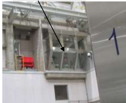
ごみクレーン操作室
