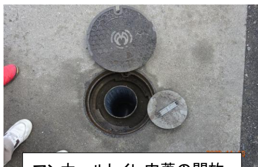
マンホールトイレ内蓋の開放
