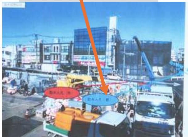
図 2 0 ; 東大和市駅前(立坑)取水人孔
