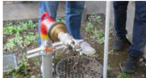
6連蛇口セットからの放水
